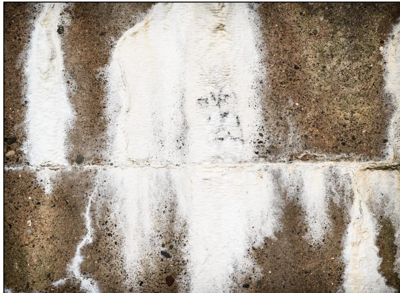
Figura 5 – Concreto atingido pela eflorescência
