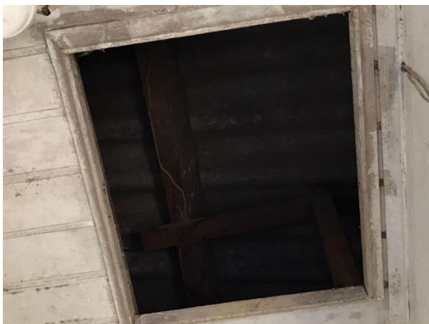
Figura 30 - Estrutura de madeira com cupins 03
