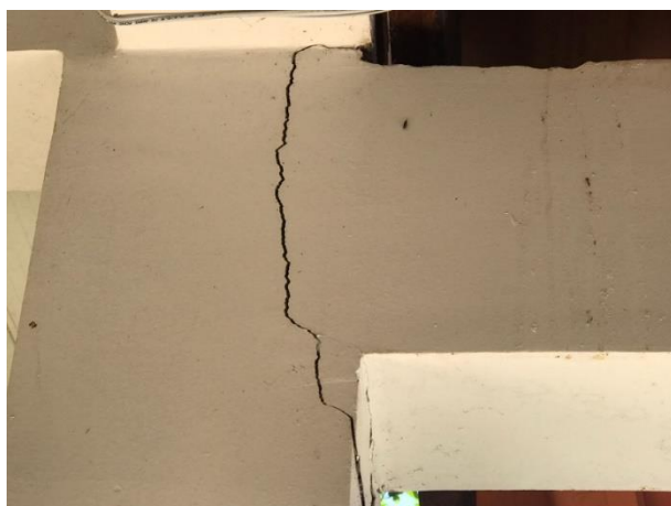
Figura 13 - Rachadura no encontro pilar/viga 02
