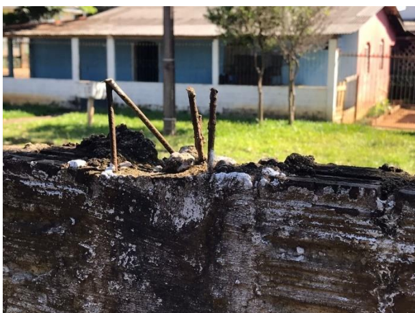
Figura 23 - Muro em treliça com ferragem exposta
