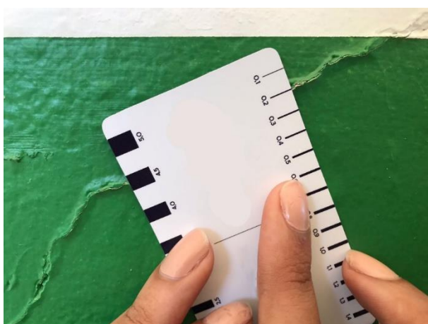
Figura 25 - Medição com fissurômetro 02
