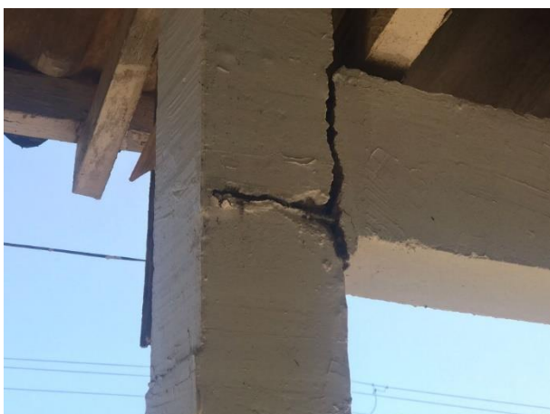
Figura 15 - Rachadura no encontro pilar/viga 03
