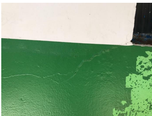
Figura 26 - Fissura em janela
