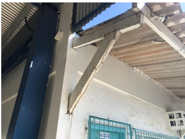
Figura 28 - Estrutura de madeira com cupins 01
