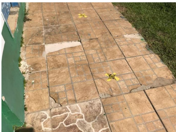
Figura 20 - Piso cerâmico quebrado
