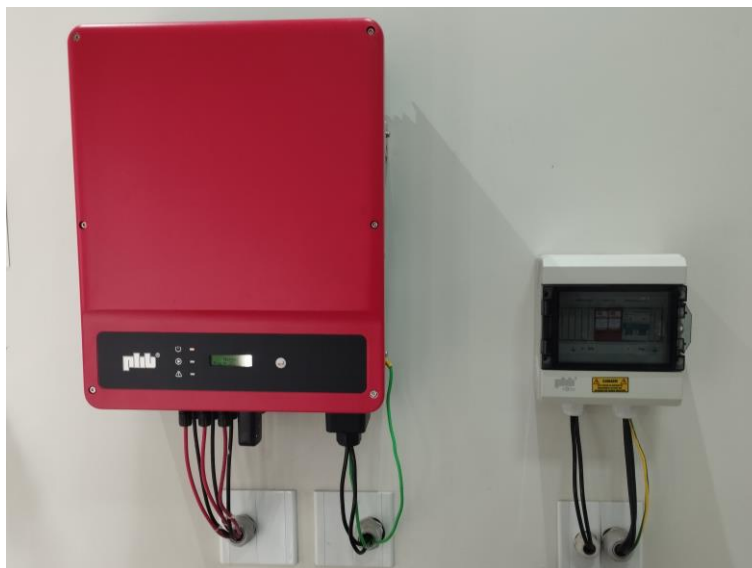
Figura 14 – Inversor solar On-grid com caixa de proteção
