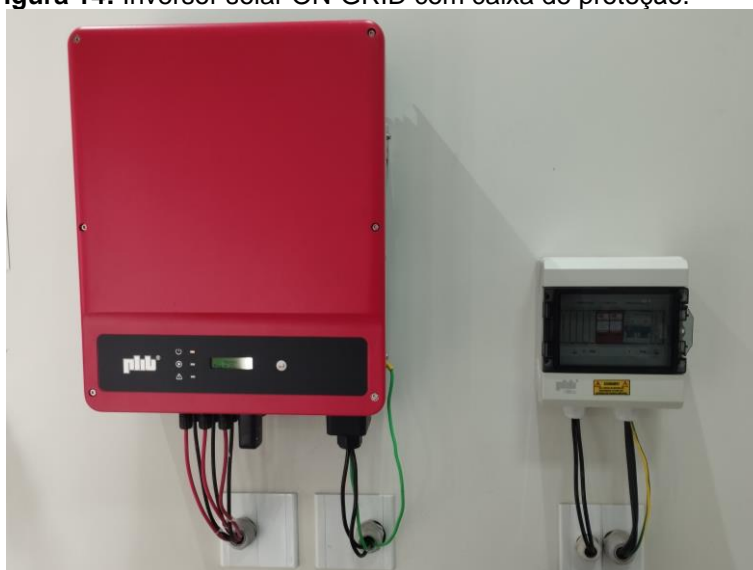
Figura 14: Inversor solar ON-GRID com caixa de proteção.
