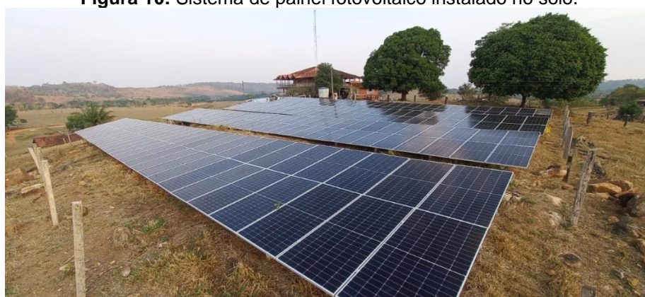
Figura 10: Sistema de painel fotovoltaico instalado no solo.
