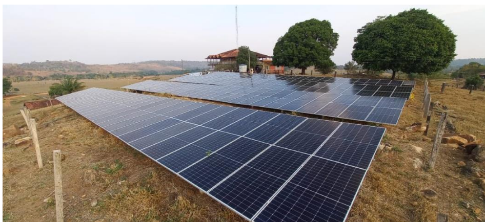
Figura 10 – Sistema de geração por meio de painéis fotovoltaicos instalados em solo
