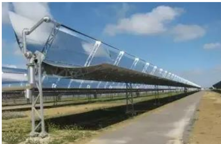
Figura 8 – Usina com painéis concentradores solares
