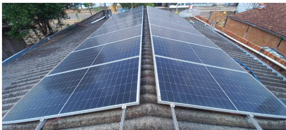
Figura 12 – Sistema de geração por meio de painéis fotovoltaicos instalados em cobertura
